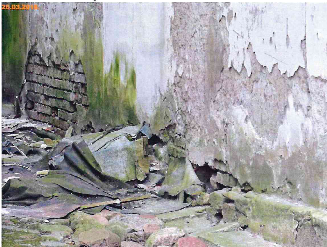
16.attēls. Bojāta ēkas kuģinieku ielā 2, Ventspilī virspamatu daļa.
