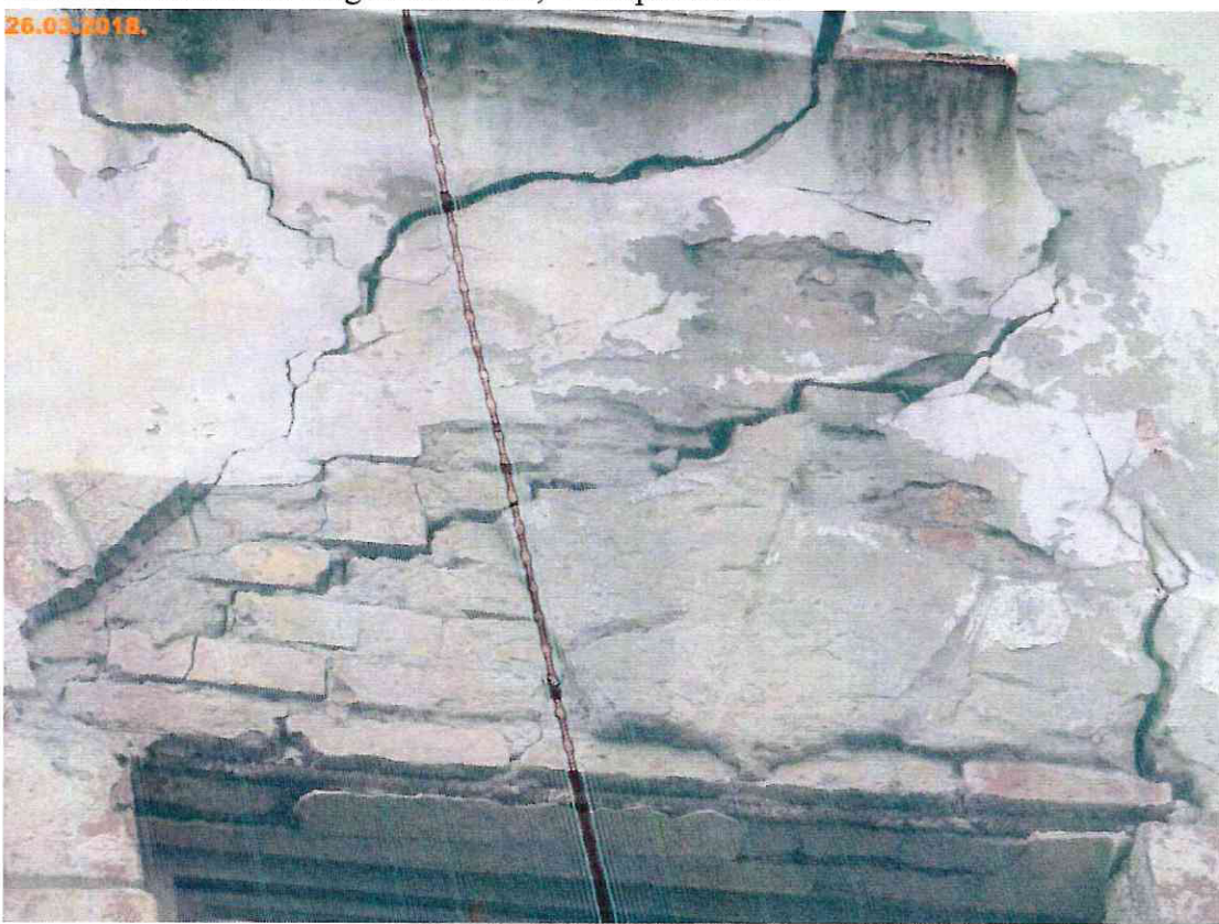
10.attēls. Plaisas ēkas Kuģinieku ielā 2, Ventspilī fasādē un bojāta loga ailas pārsedze.
