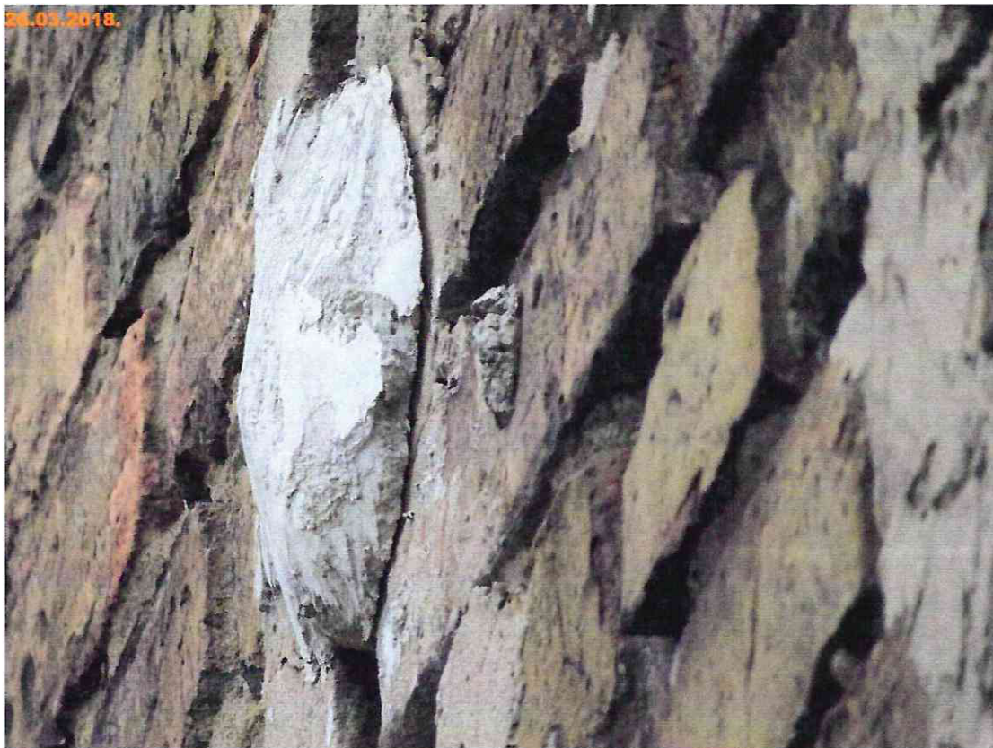
15.attēls. No mūra atdalījusies marka.
