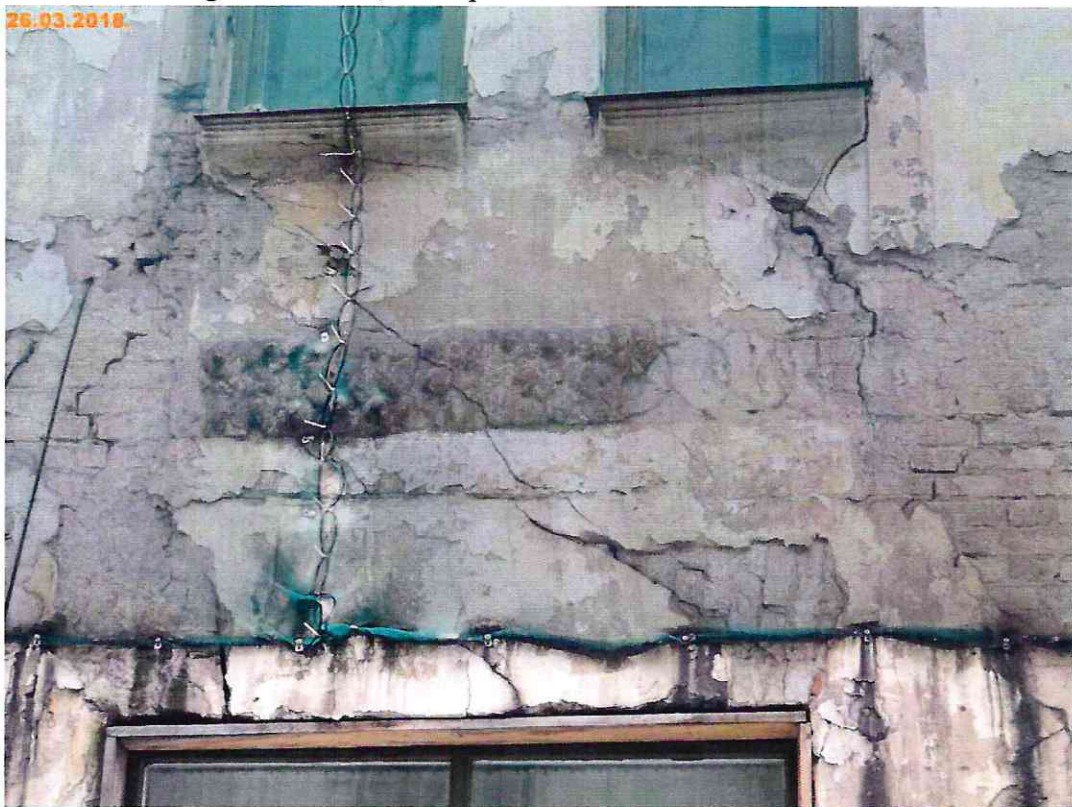
2.attēls. Plaisas ēkas Kuģinieku ielā 2, Ventspilī fasādē.
