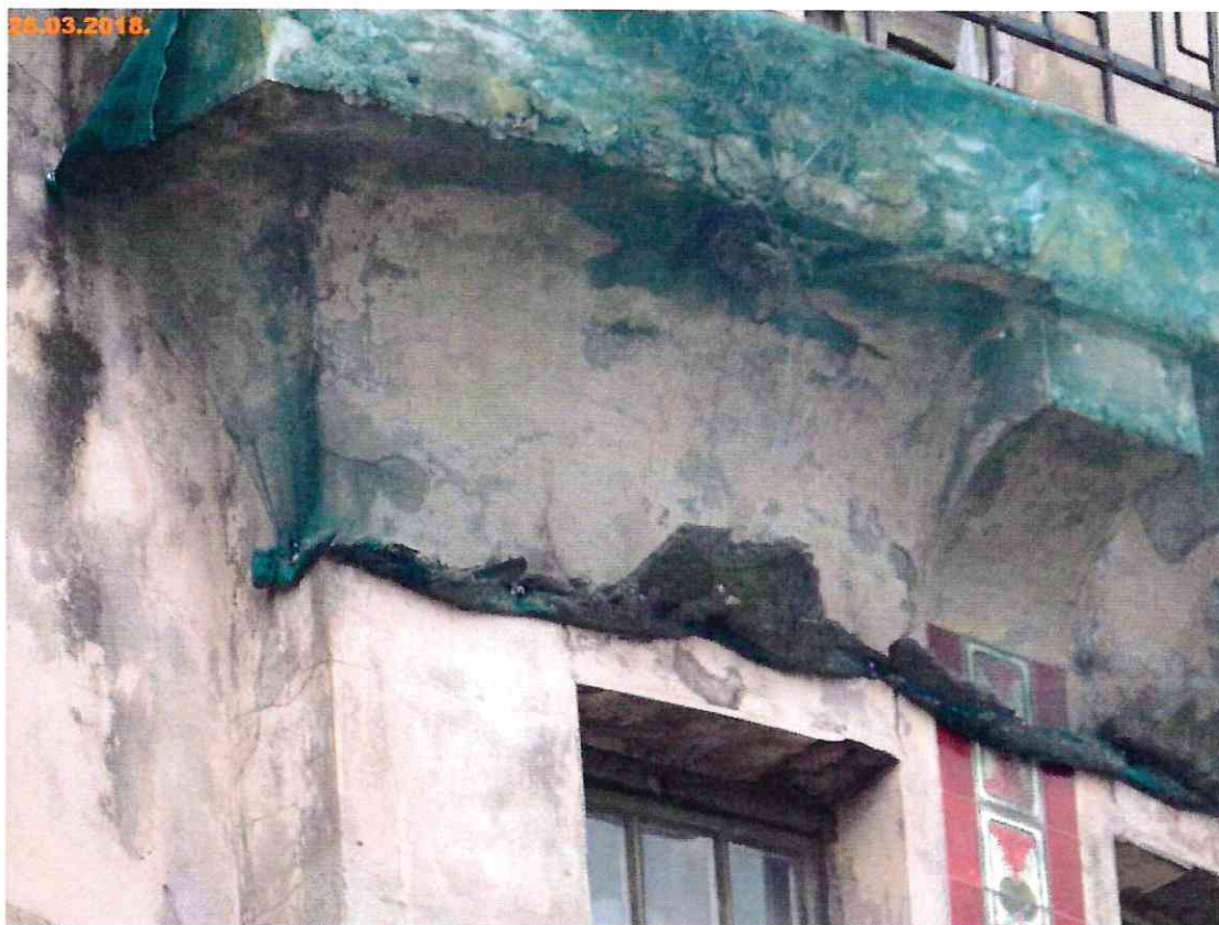
5.attēls. Fasāžu aizsargtīklā iekārušies fasāžu apmetuma gabali.
