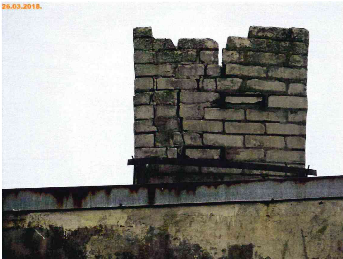
11.attēls. Bojāts ēkas Kuģinieku ielā 2, Ventspilī skurstenis.
