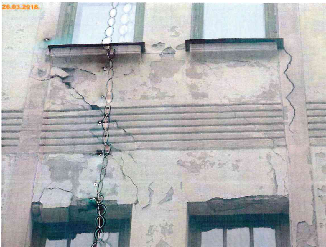
9.attēls. Plaisas ēkas Kuģinieku ielā 2, Ventspilī fasādē.
