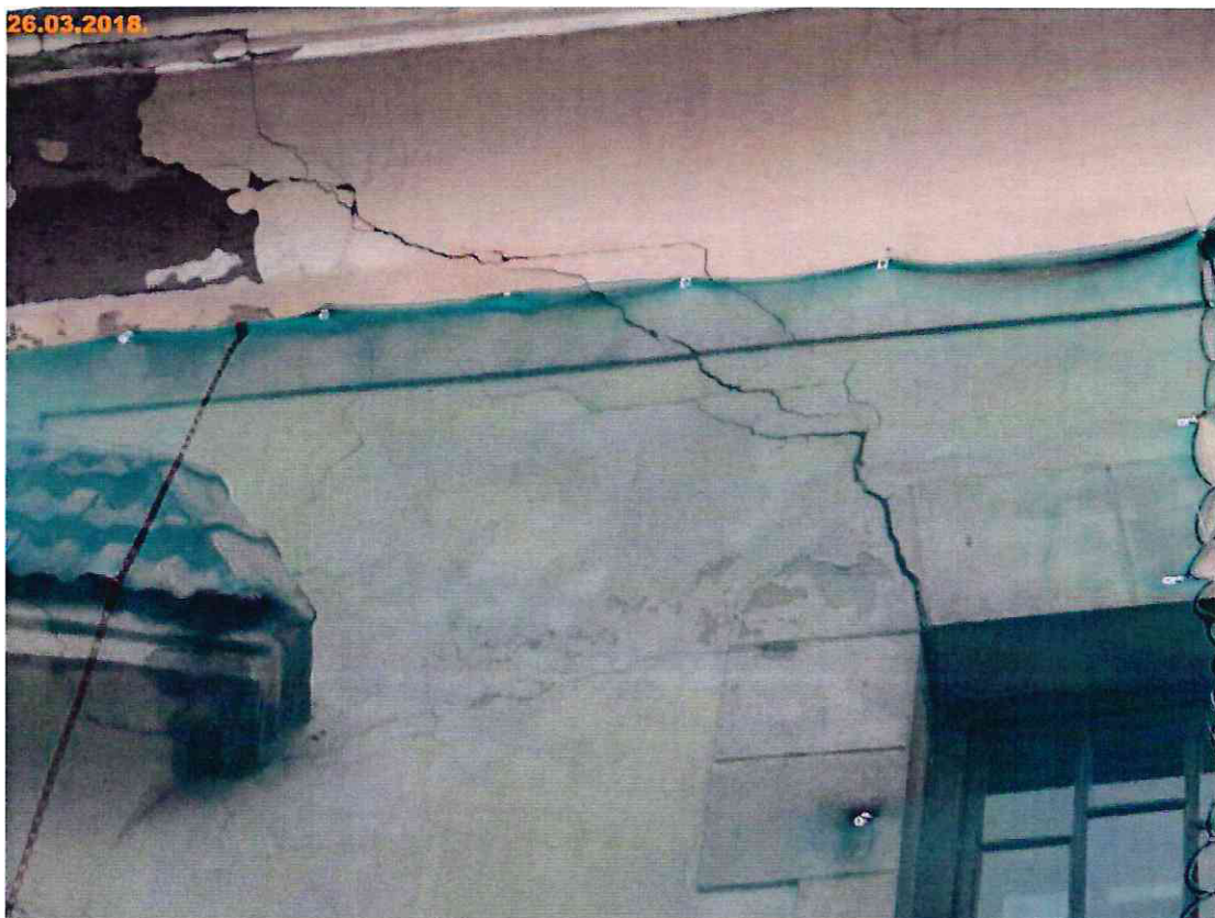
3.attēls. Plaisas ēkas Kuģinieku ielā 2, Ventspilī fasādē.
