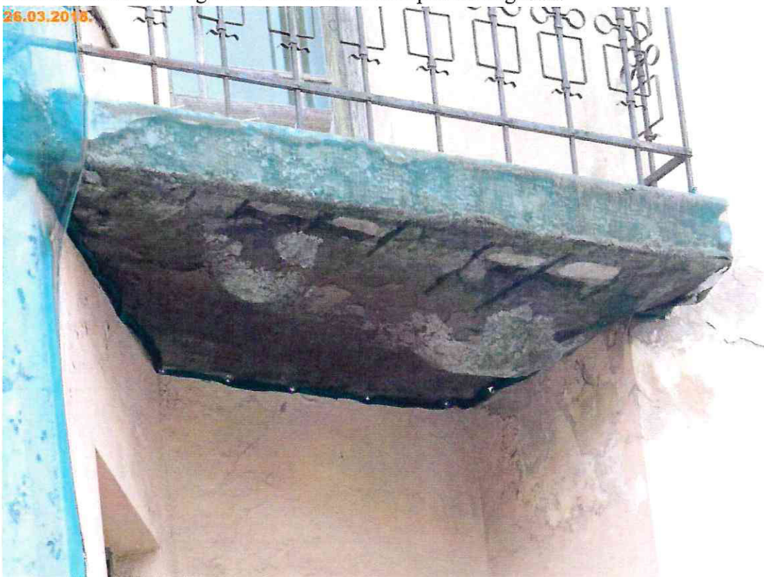
6.attēls. Fasāžu aizsargtīklā iekārušies betona gabali.
