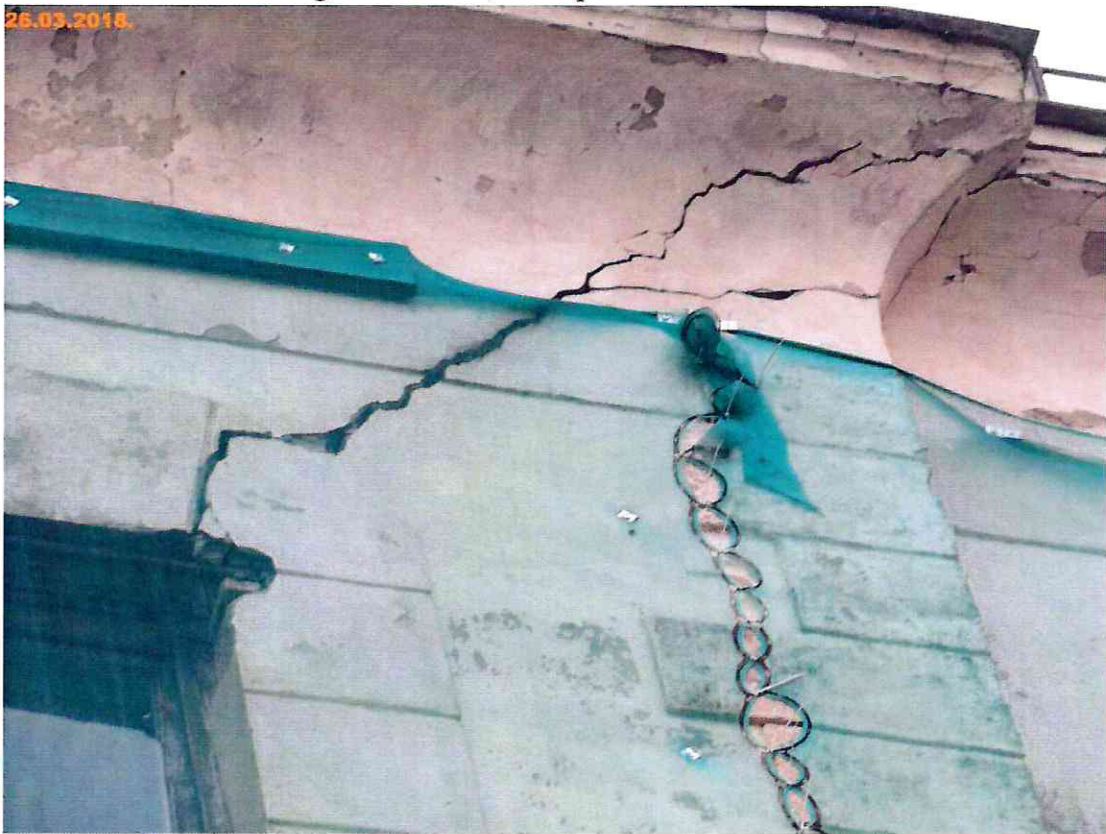
4.attēls. Plaisas ēkas Kuģinieku ielā 2, Ventspilī fasādē.
