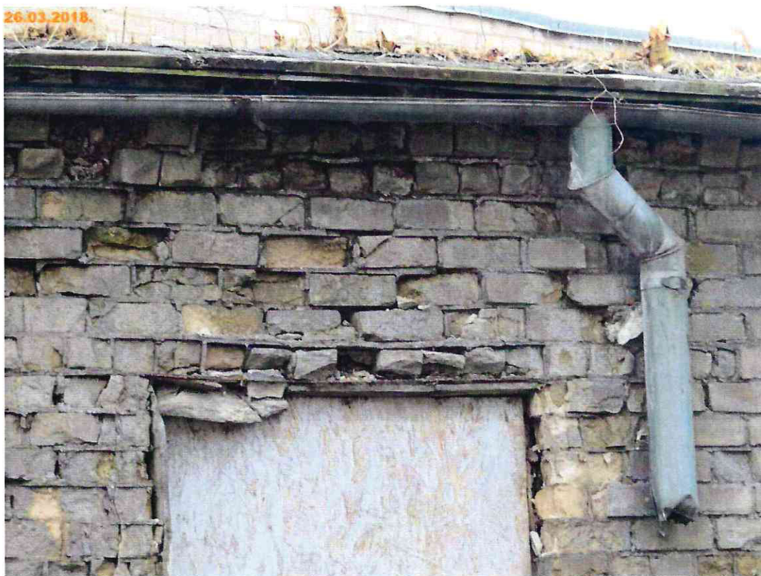
11.attēls. Palīgēka Pils ielā 38, Ventspilī.
