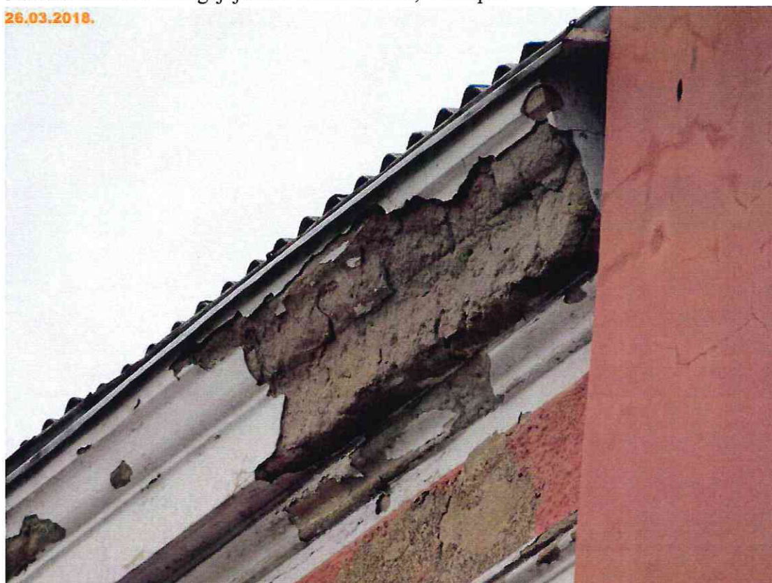
4.attēls. Ēkas Pils ielā 38, Ventspilī fasādes bojājumi.
