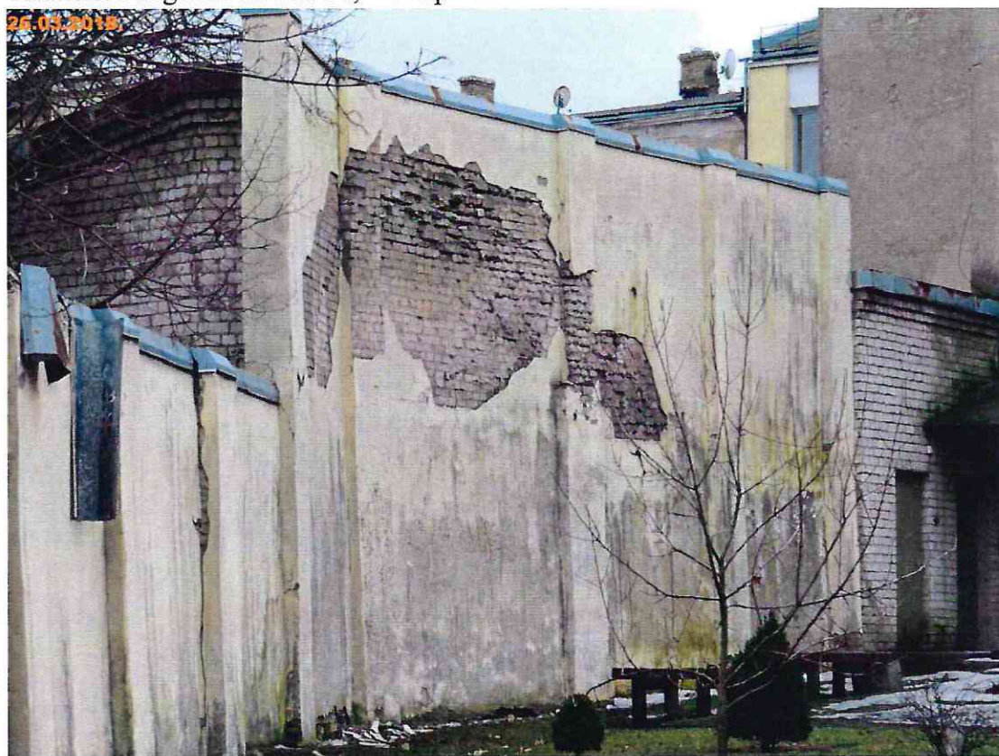
12.attēls. Palīgēka Pils ielā 38, Ventspilī.
