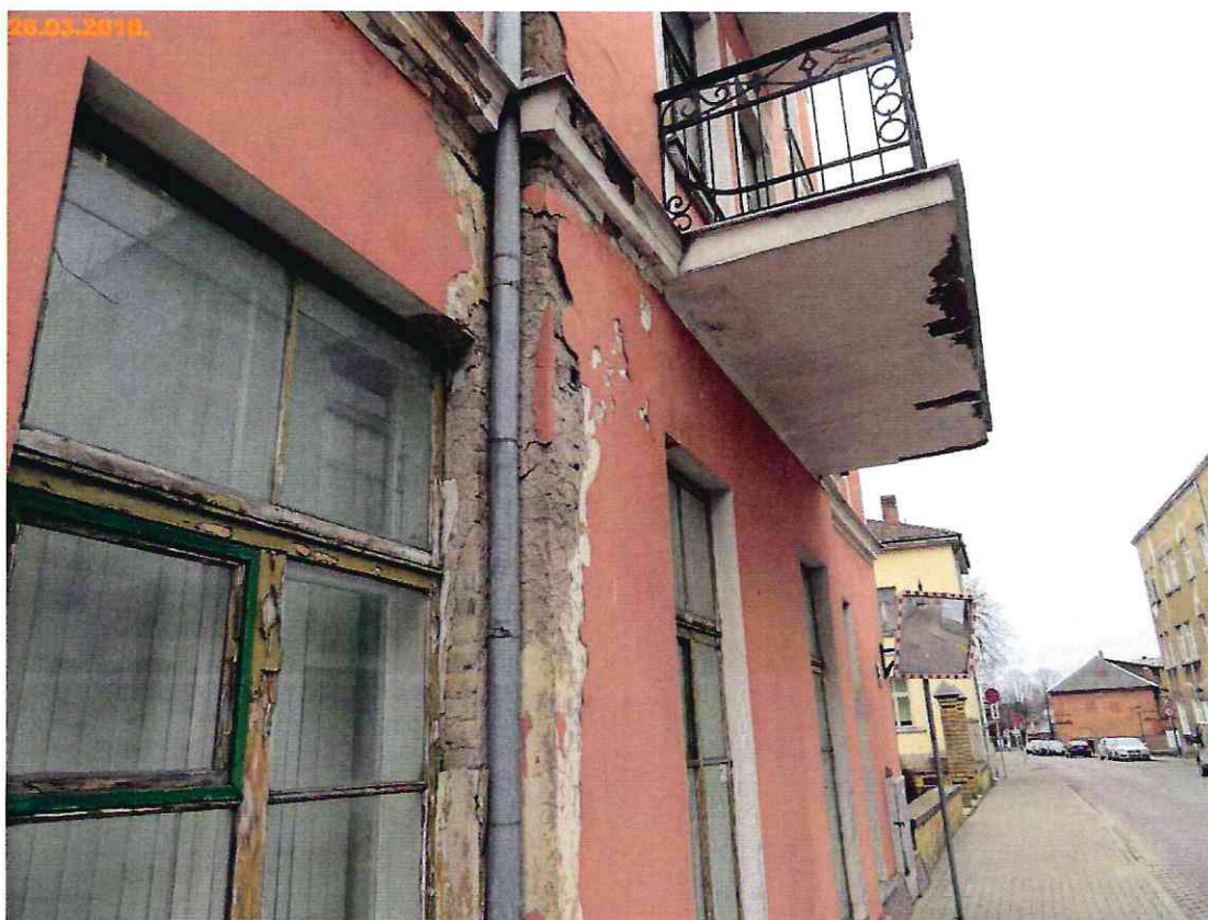
5.attēls. Ēkas Pils ielā 38, Ventspilī fasādes bojājumi.
